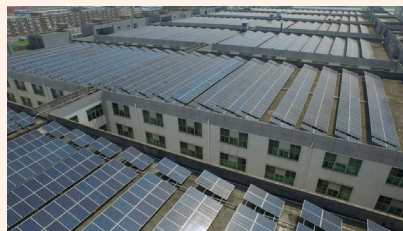
廠房屋頂太陽能光伏板
