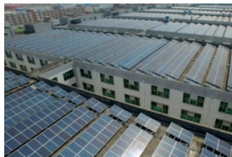
廠房屋頂太陽能 光伏板
